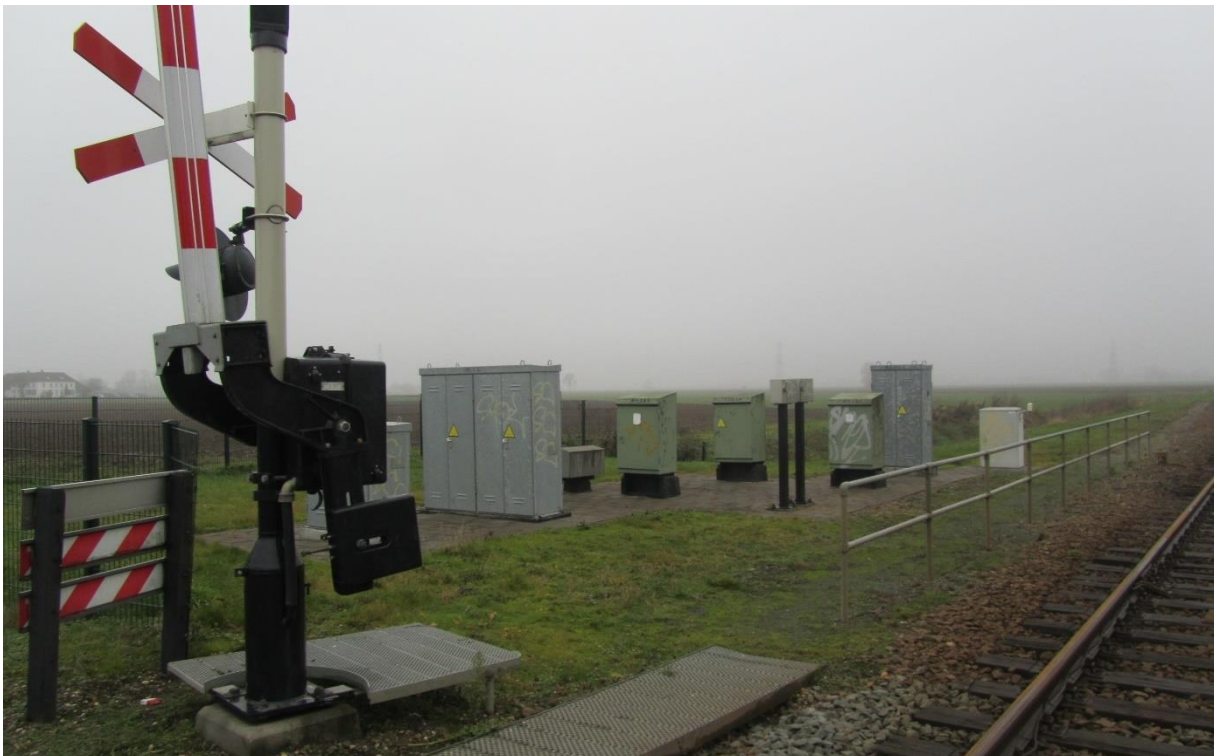
Tel de schakelkastjes bij de overweg tussen Elst en Oosterhout op het traject naar Tiel.
