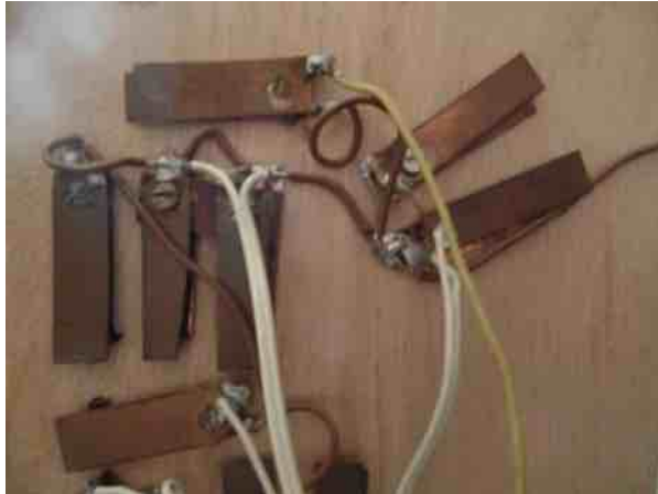
onderzijde oud schakelbord: stukjes wekkerveer
