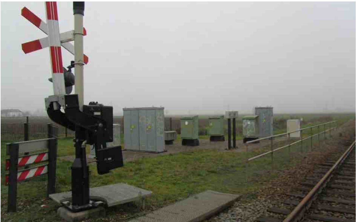
Tel de schakelkastjes bij de overweg tussen Elst en Oosterhout op het traject naar Tiel.
